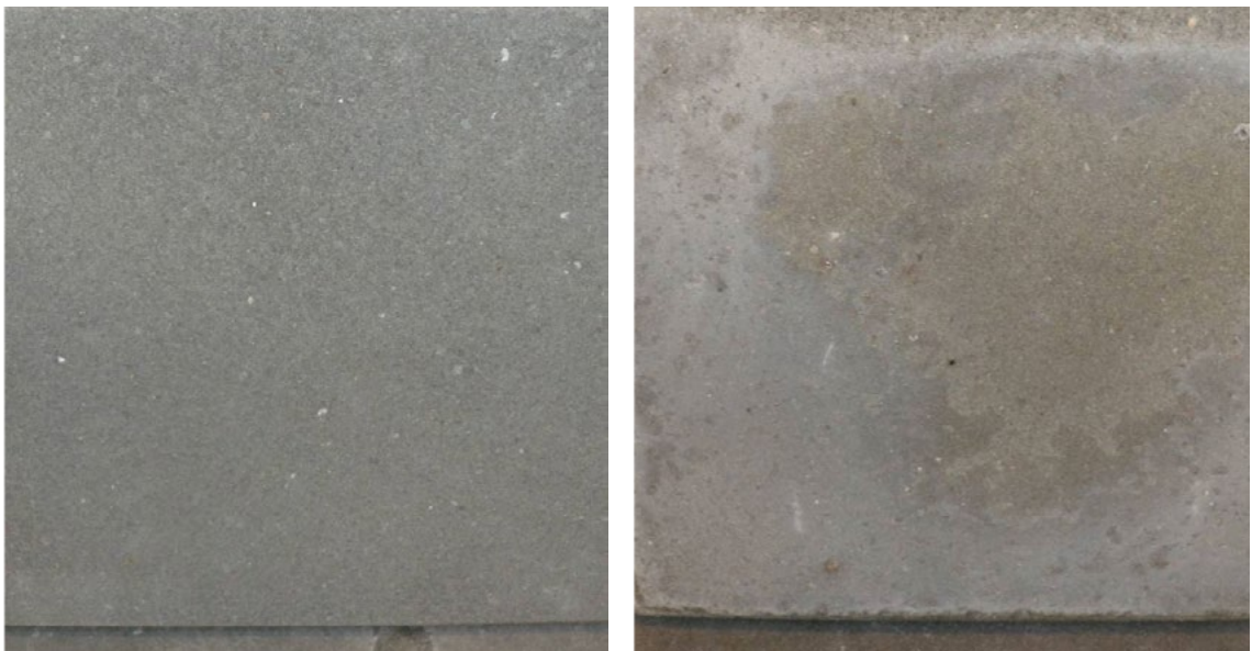
Figur 121 – Betonoverflader m./u. ventilation. Tv. ses overfladen fra fliser, som har været lagret med 10mm afstandsbrikker. Th. ses overfladen fra fliser, som har været lagret helt tæt op ad hinanden.
