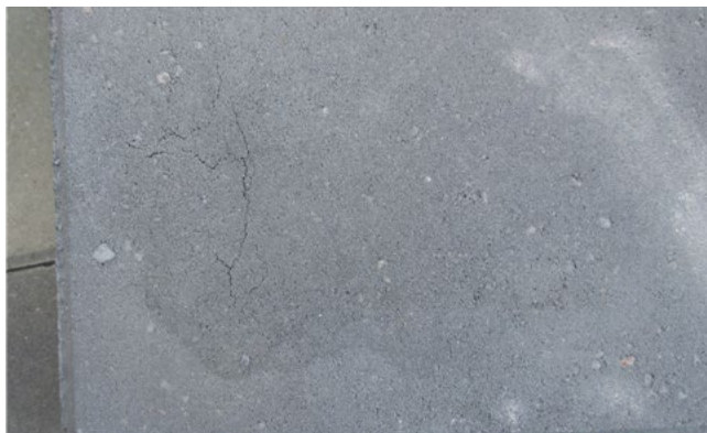
Figur 103 – Vibrationsrevner og varierende overfladeudseende på konkav overflade i fliseproduktion.
