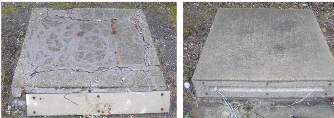
Figur 87 – Flise produceret med hhv. tilslag med porøs flint (tv.) og tilslag uden porøs flint (tv.). Det ses hvordan betonen med dårligt tilslag (tv.) er skadet af alkali-kisel-reaktioner.
