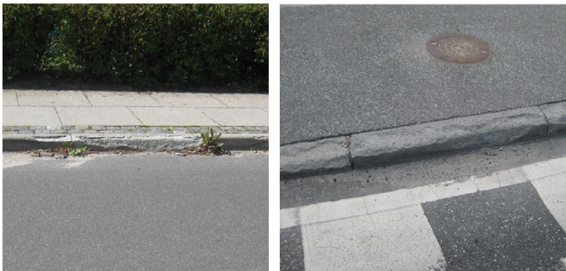
Figur 106 – Eksempel på delaminering i to-lags beton.
