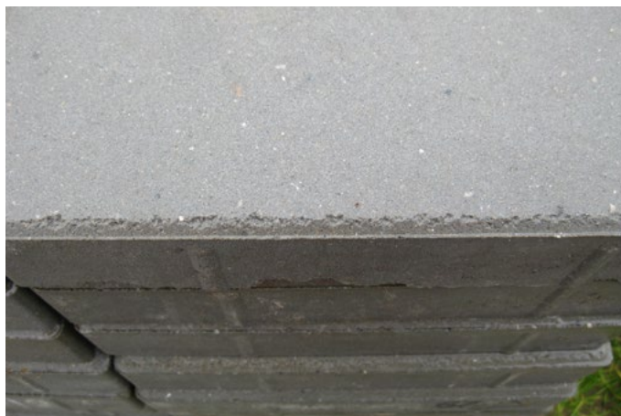
Figur 109 – Napning observeret ved flisekant.
