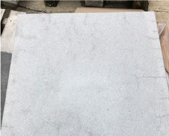
Figur 110 – Udtørningsrevner observeret i betonfliser.
