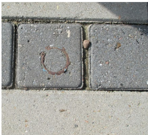
Figur 98 – Eksempler på fremmedlegemer i form af maskindele observeret i betonvarer.
